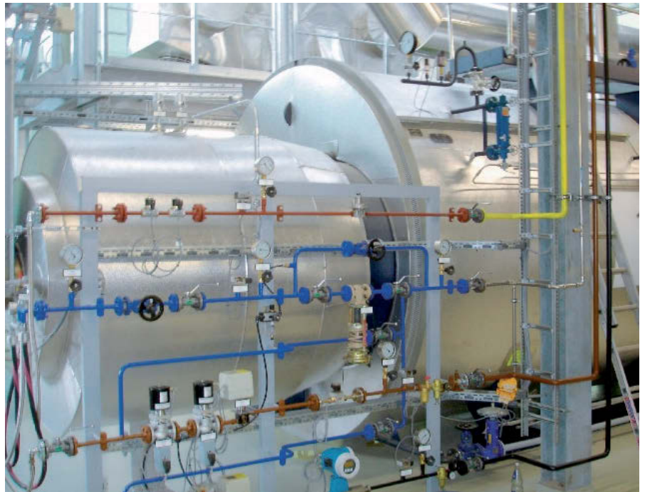
Per ridurre l'impatto ambientale gli impianti di riscaldamento sono dotati di camere di combustione ad alta temperatura e di depuratori dei gas di scarico
